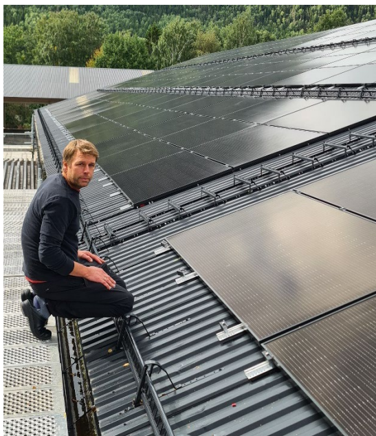
Hallstein Holen sjekker solcellene som er montert på taket på testingsstasjonen på Øyer.
